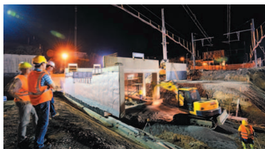
Mise en place de la structure préfabriquée sous la voie ferrée du futur passage Orsel
